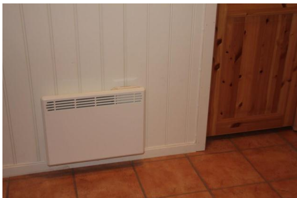
Bilde over: Ved toalettet i klubbhuset er det satt opp skillevegg og varmeovn, som gjør at toalettet kan brukes selv om det ikke er annen aktivitet i lokalene. (begge foto: Øistein Wien)
